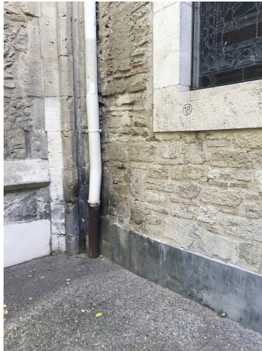
Murs et gouttière sales
