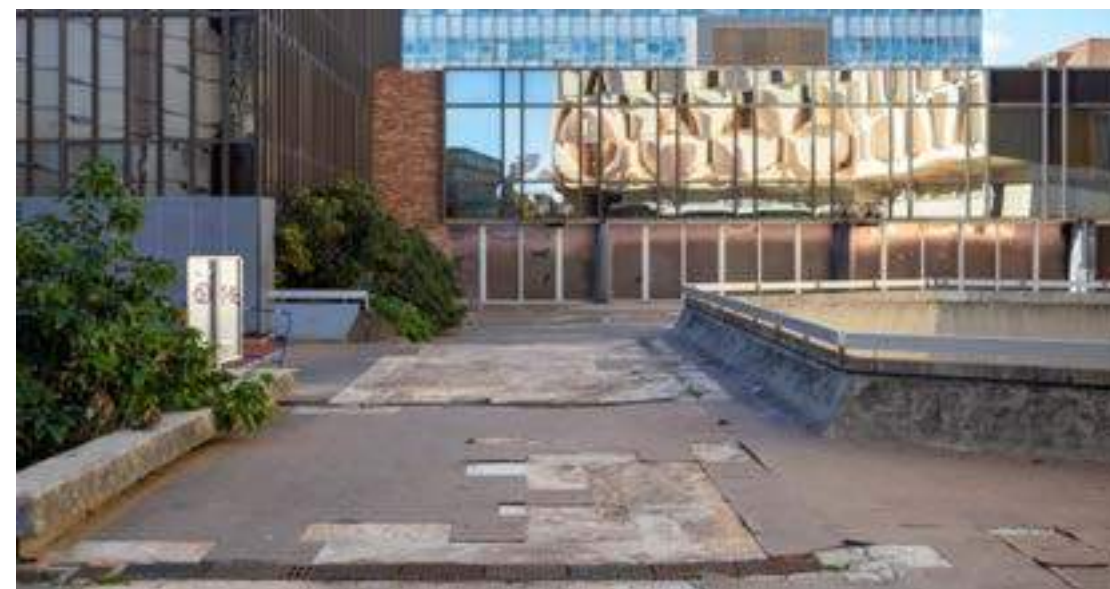
Figure 121 : Dégradations au niveau du secteur Pagézy
