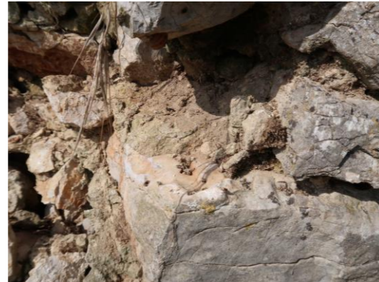
Fig.57. La maçonnerie de parement et de blocage du mur, M1, de la piste. Cl. V. Rousset, 2021
