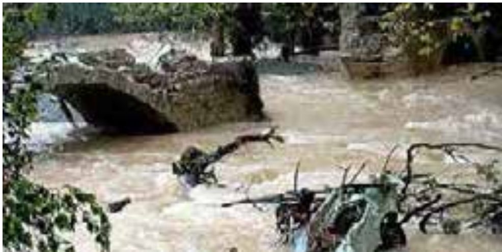
Figure 1 : Photo du Vieux Pont de la Mosson lors de la crue d'octobre 2014
