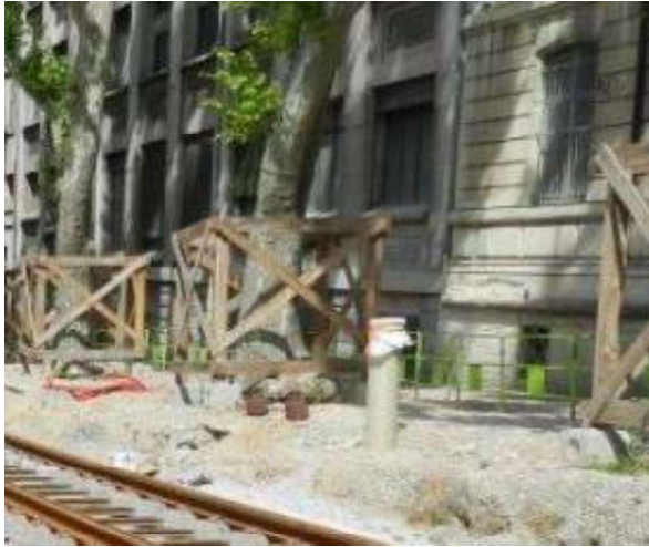
Exemple de palissade en bois disposée autour des arbres à protéger (source : tramwaydemontpellier.net)
